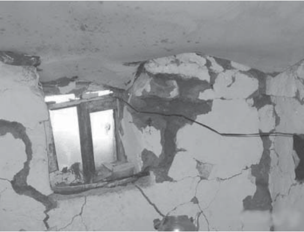
Köy konu- tunda meydana gelen tipik bir hasar örneği (Viranşehir)
