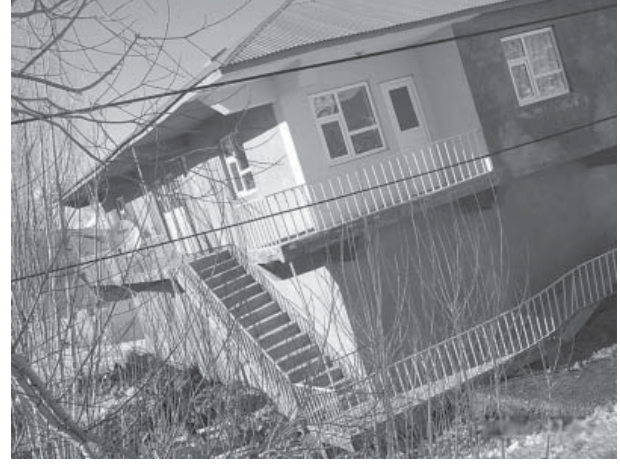
3 katlı karkas yapının dere yatağına doğru eğilmesi
